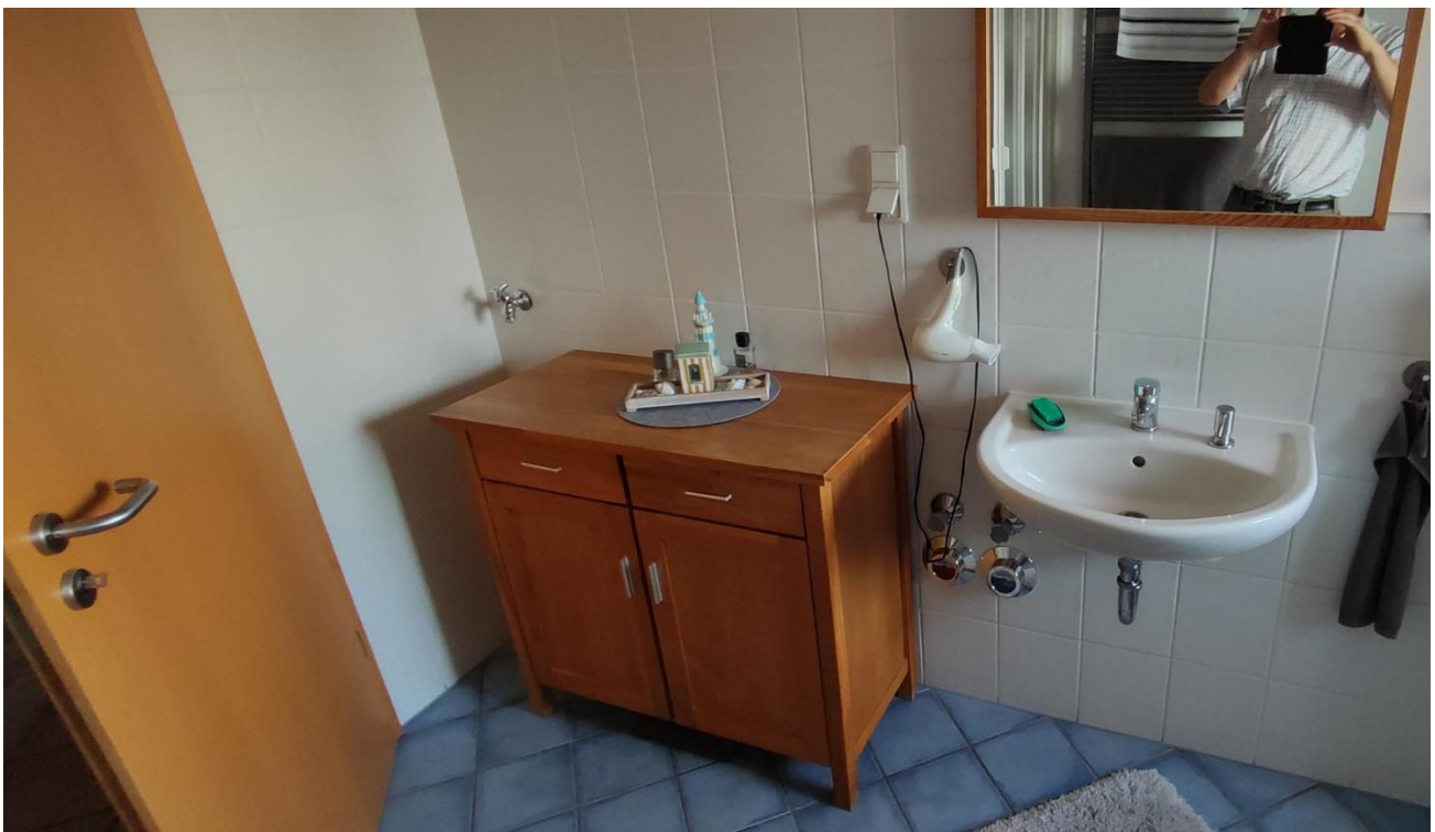
Bad mit Waschmaschinenanschluß
