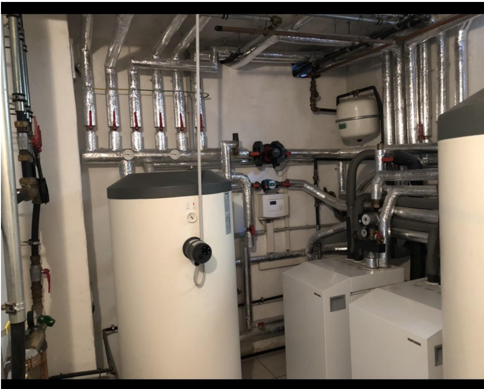
Teil vom Heizraum
