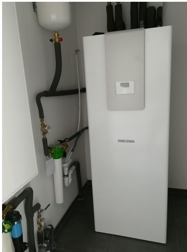
Technikraum u. Luft-Wärmepumpe
