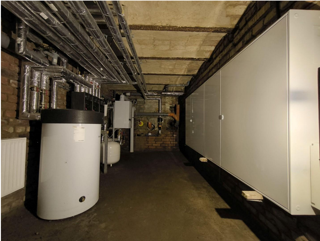
Heizungskeller u. E-Verteilung
