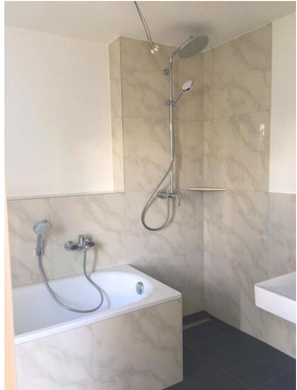
Badezimmer EG Rainshower
