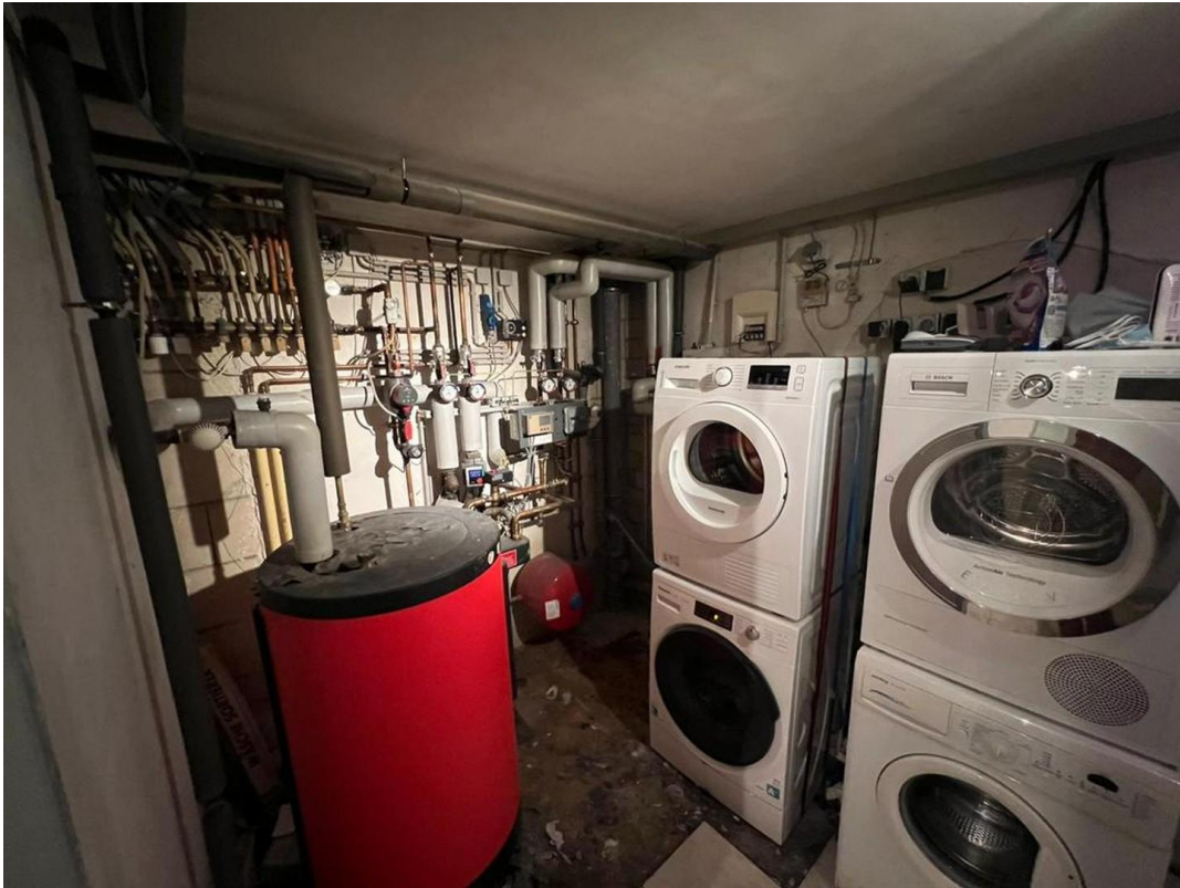
Wäscheraum mit Heizung
