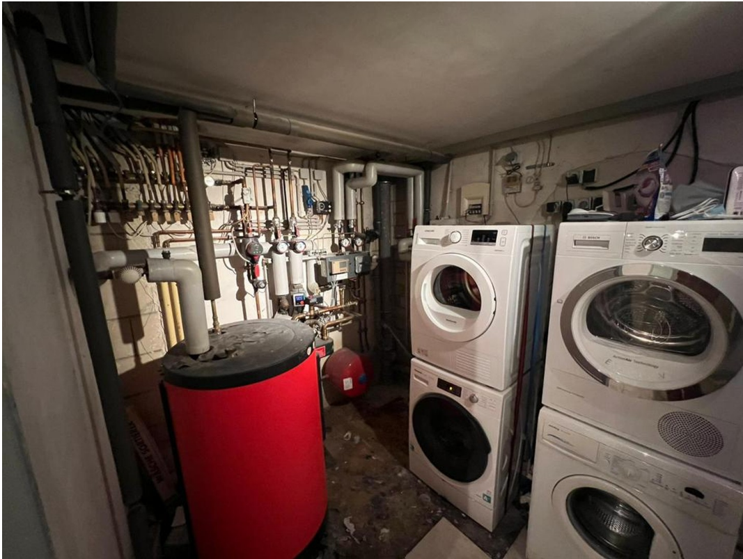
Wäscheraum mit Heizung
