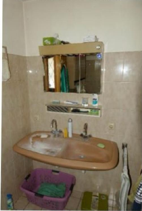
Bild 8 und Bild 9 – Bad/WC EG
