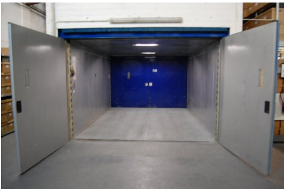
Grosser Lastenaufzug zum Obergeschoss (3.5t Ladegewicht mit L 4.80m x B 3.40m x H 2.40m)
