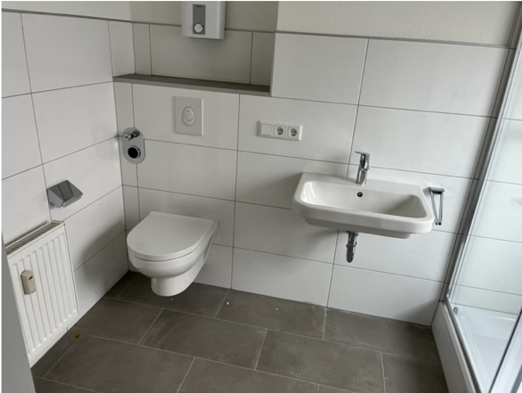
Bad / Toilette / Waschbecken
