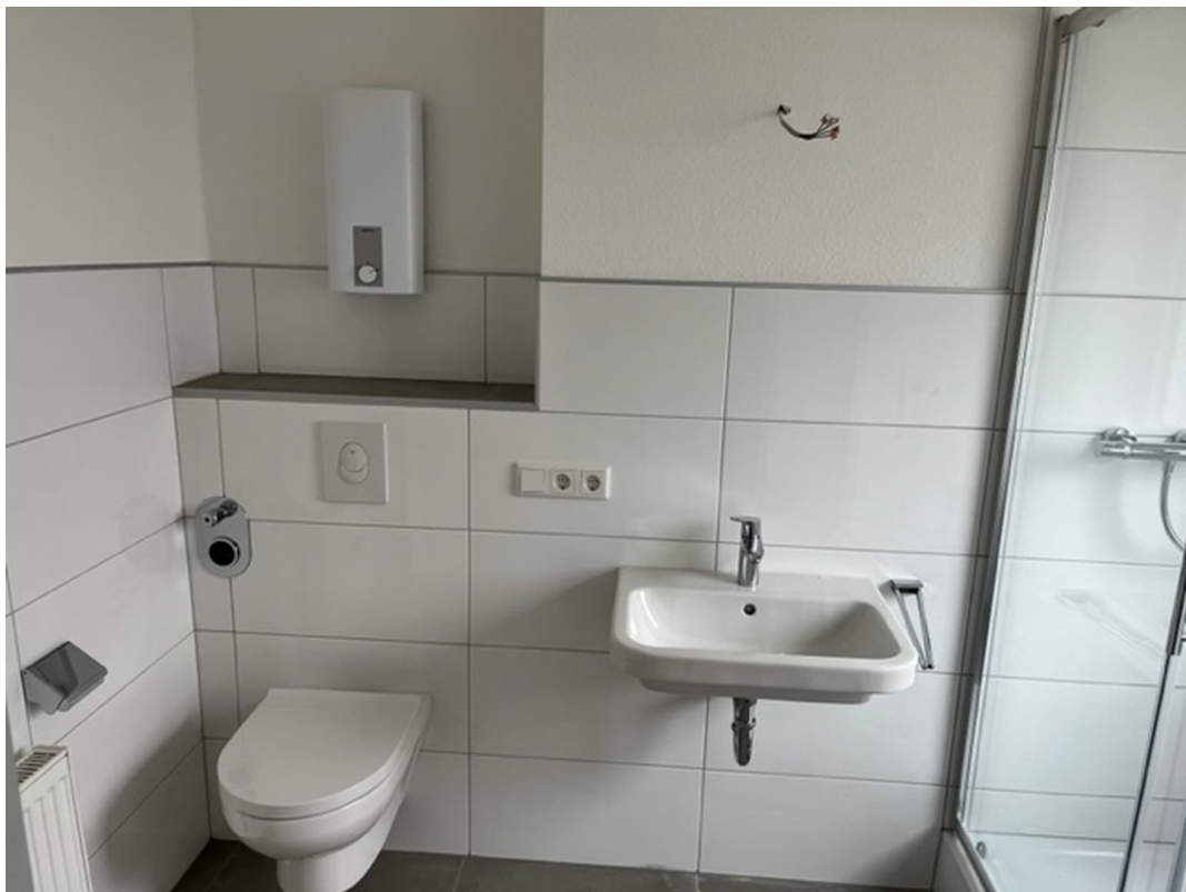
Bad / Toilette / Waschbecken
