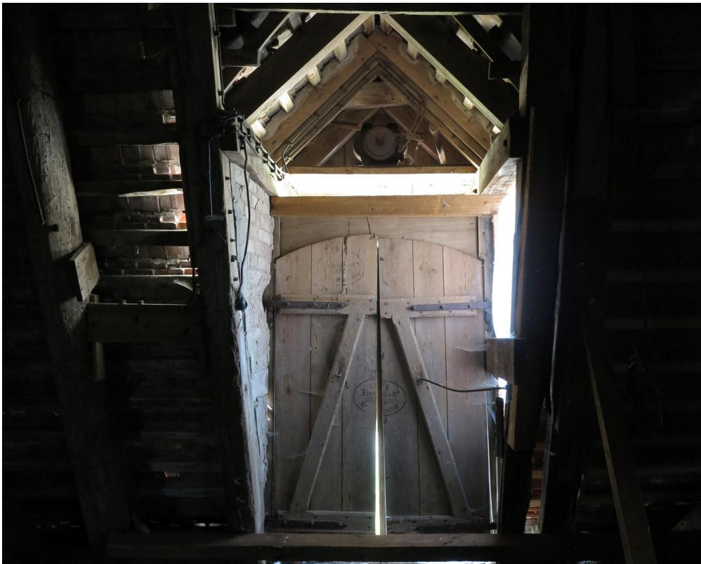
eines der beiden Krantore DG
