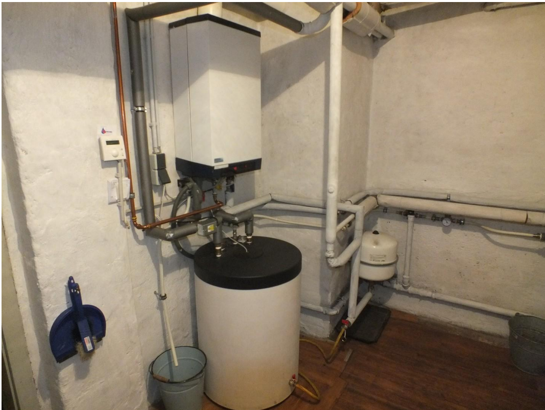
Heizraum im Keller
