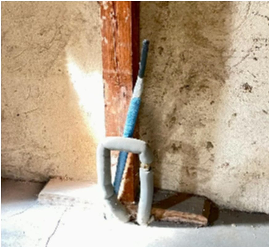
Anschlüsse für Dachwohnung
