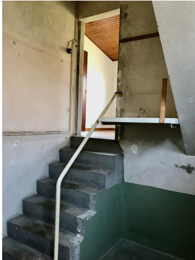
EG O Heizungskeller - nach NW
