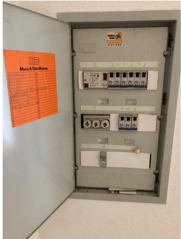
EG Flur - Sicherungskasten
