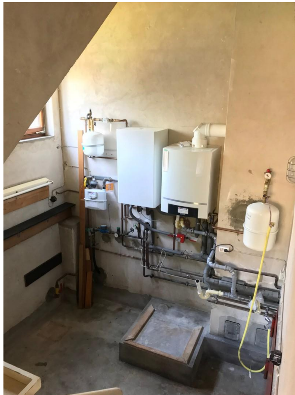
EG O Heizungskeller - nach SO
