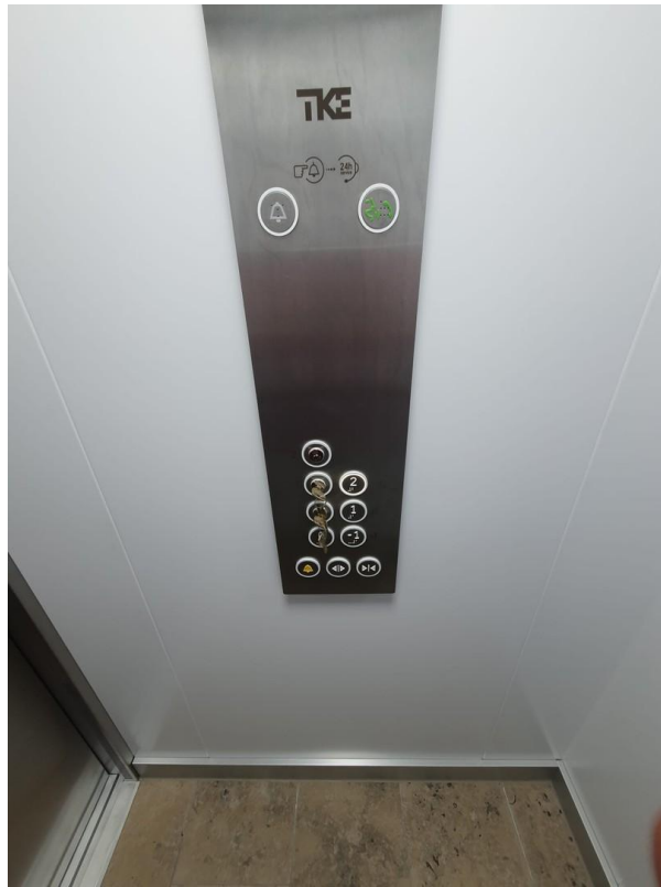
Aufzug mit separatem Zugang
