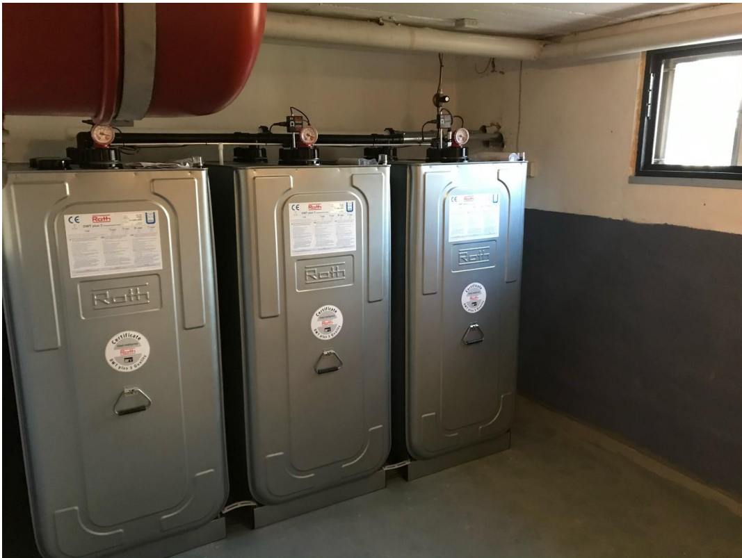
KG 3 neue Öltanks 3000 l
