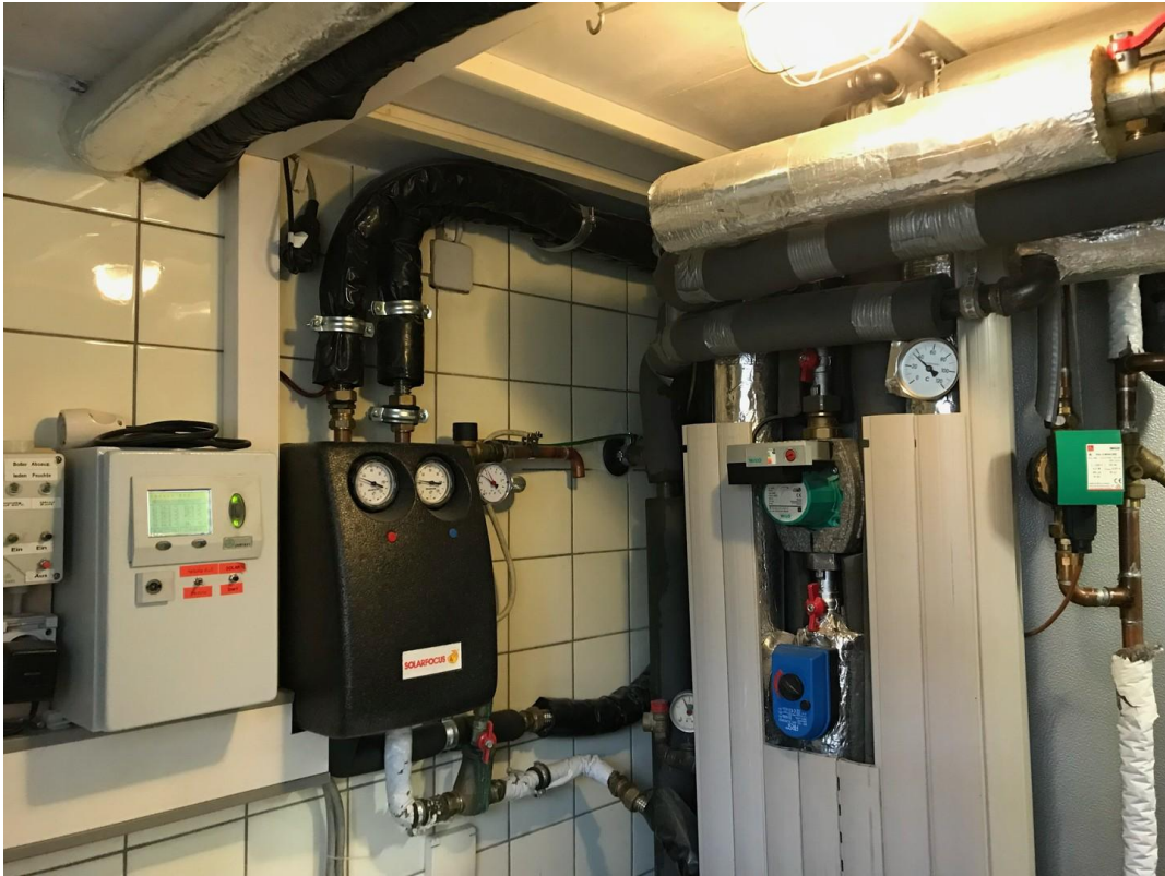
KG 800 l Speicher mit Steuerun
