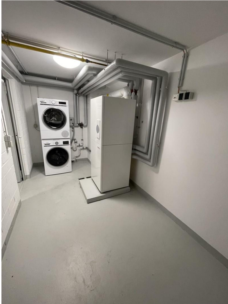
Heizungsraum mit WM+Trockner
