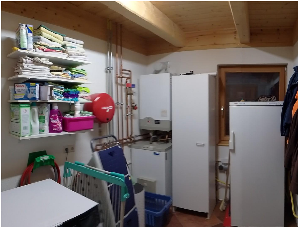
Heiz- u. Waschraum
