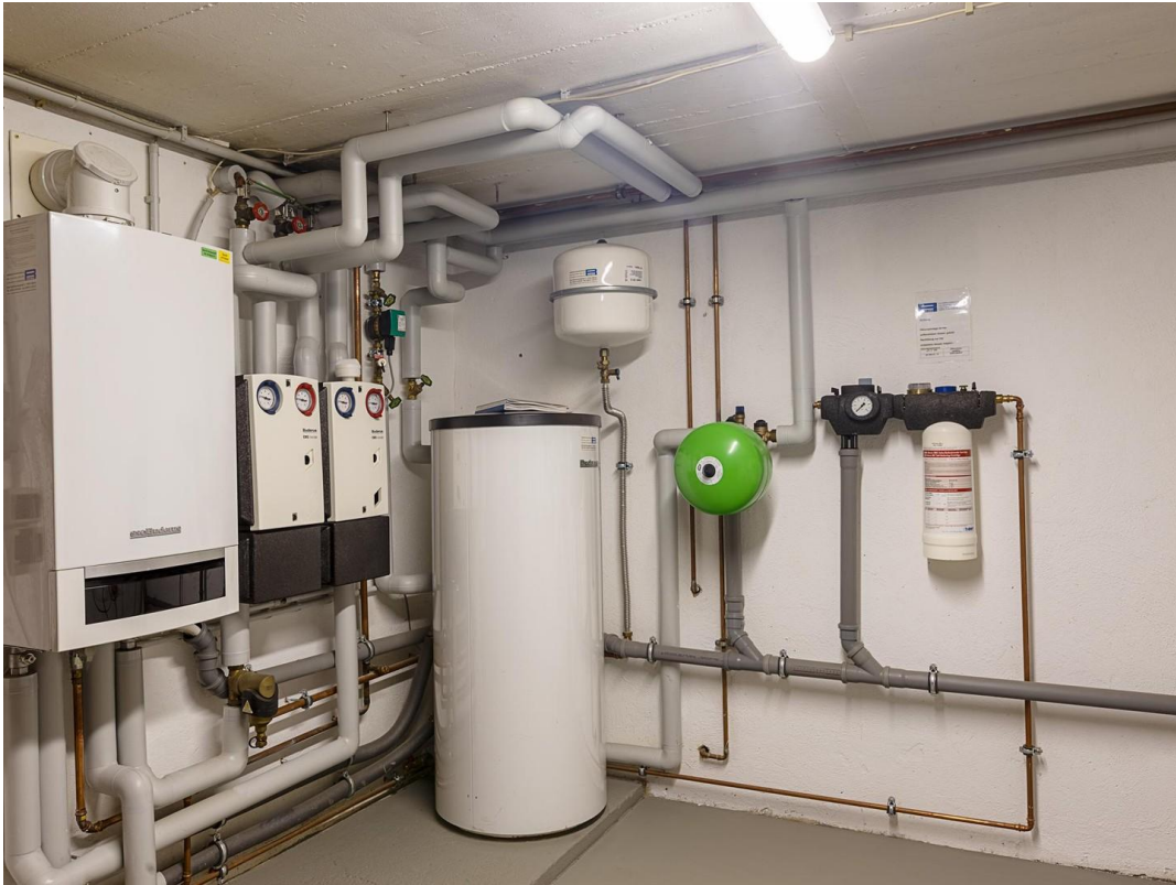
Heizungsraum m. Buderus Therme
