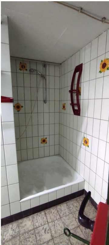
Dusche in der Waschküche
