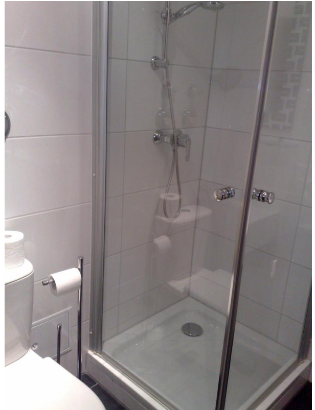
Dusche mit Glastrennwand
