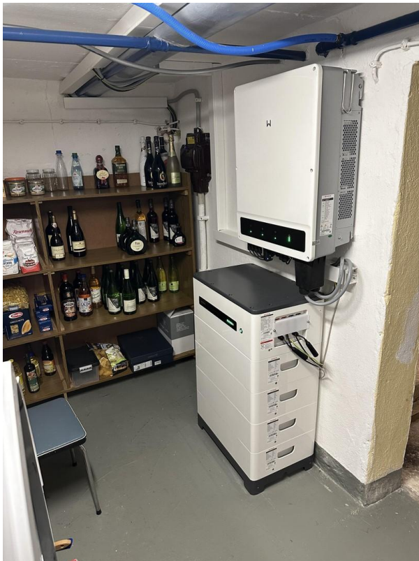
Keller mit PV Speicher
