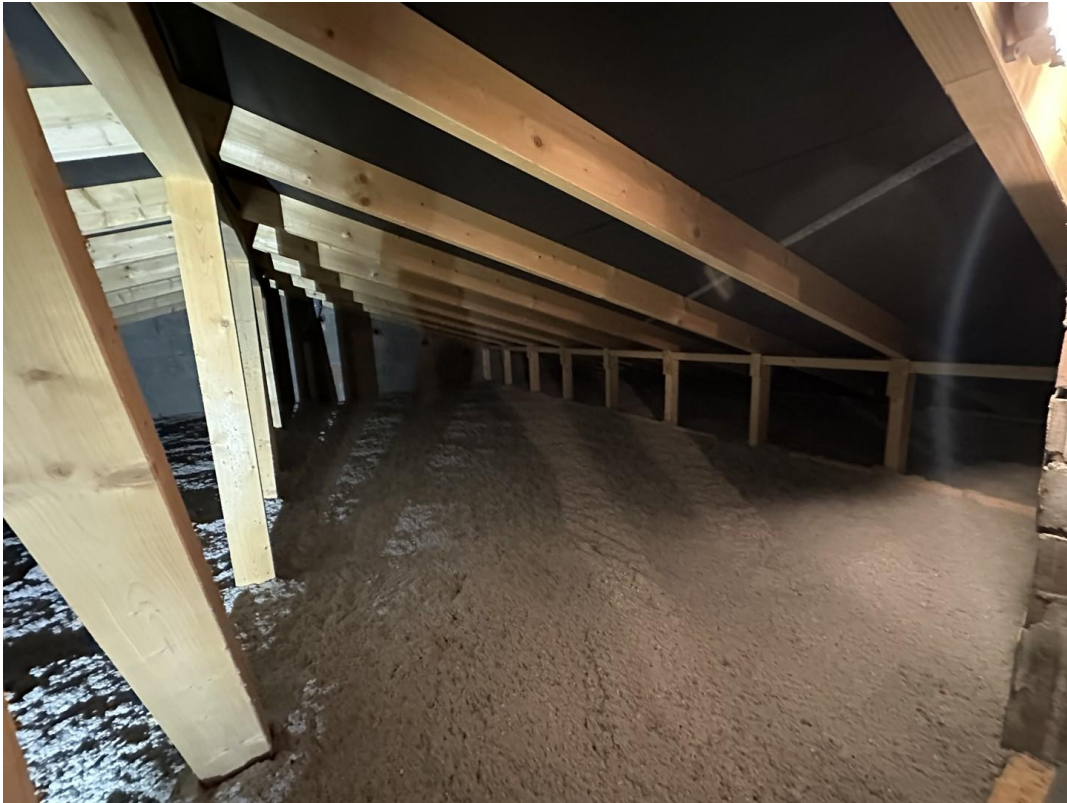
Dachboden mit Flockung
