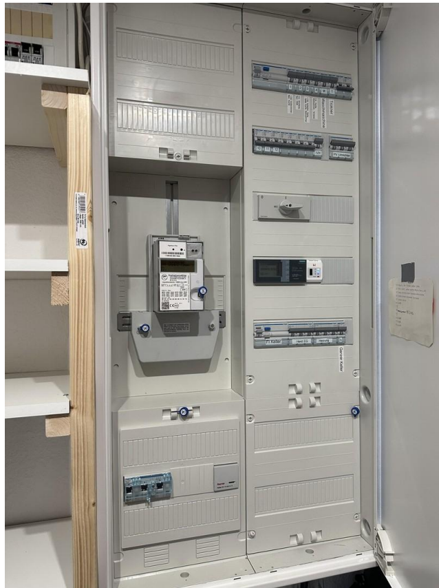
Elektroverteiler mit Notstrom
