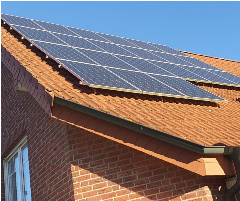
Solaranlage + Speicher 7,6 kW
