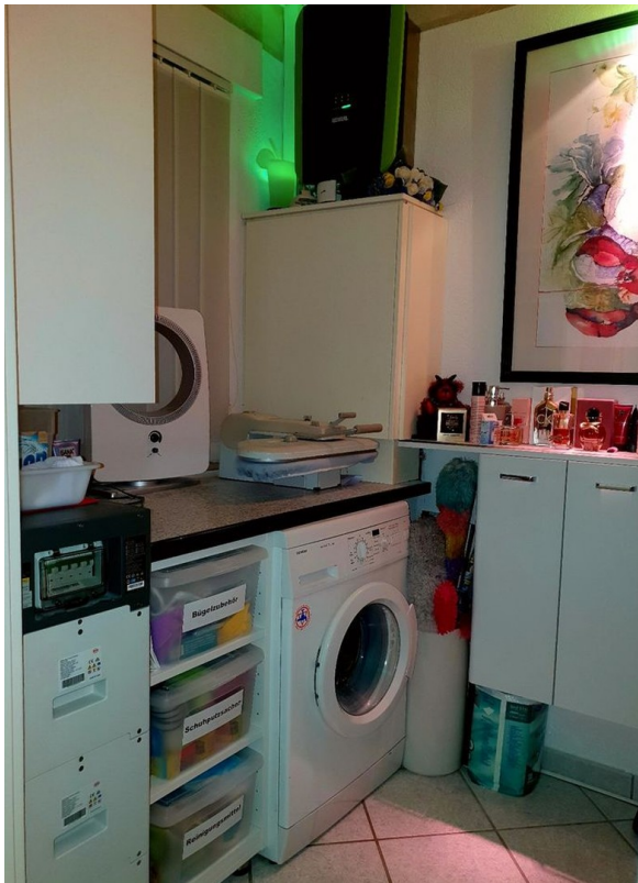
HWR mit Solarspeicher 7,6 kW
