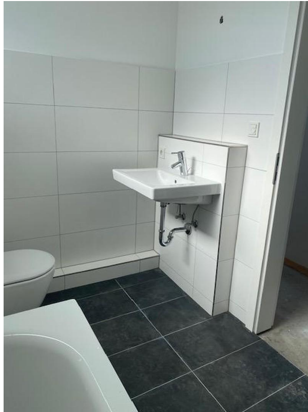
Bad/WC, Dusche OG
