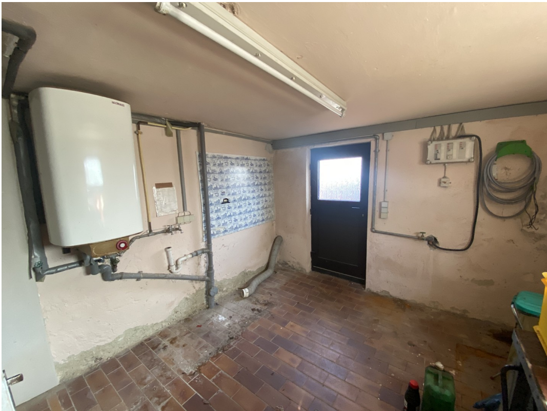
DHH 2 UG - Kellerraum
