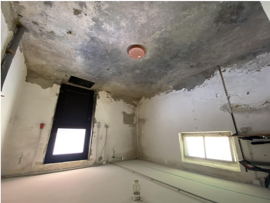
DHH 1 UG - Kellerraum
