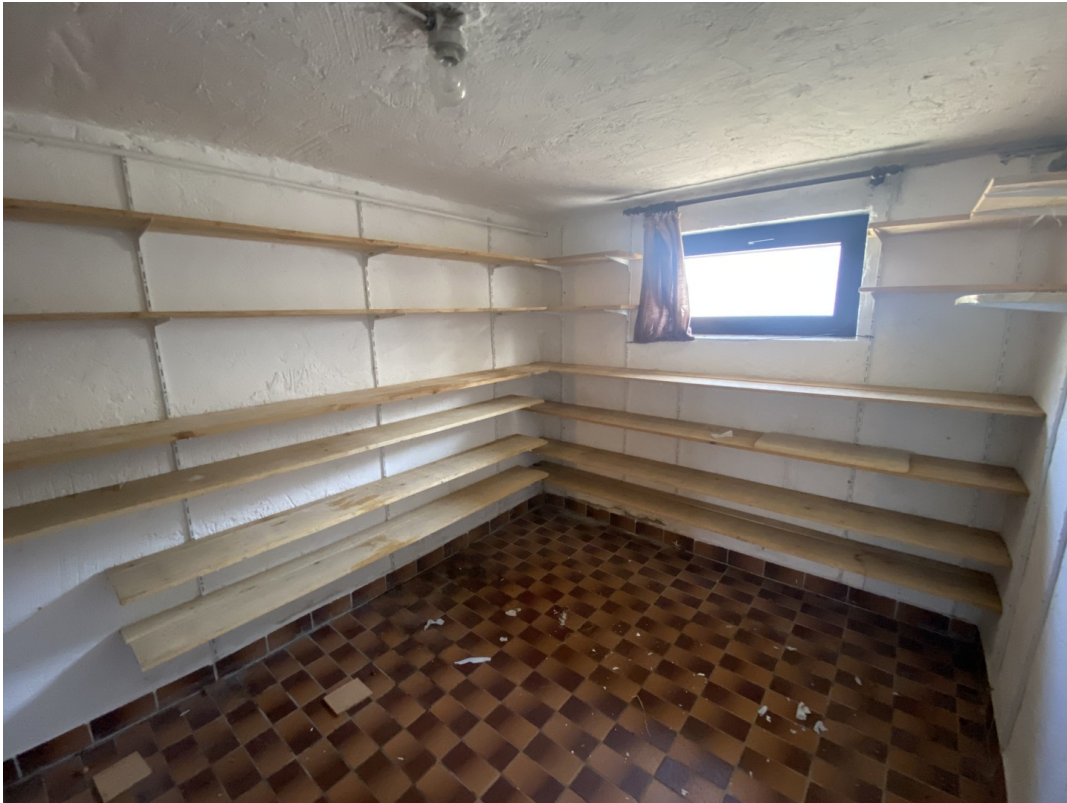
DHH 2 UG - Kellerraum
