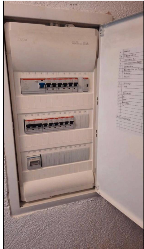
Elektrokasten mit FI-Schutz
