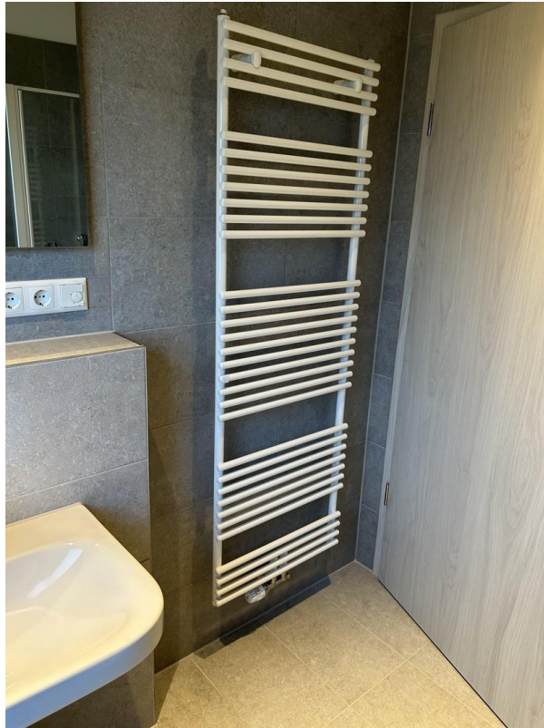
Heizkörper Bad Wohnung
