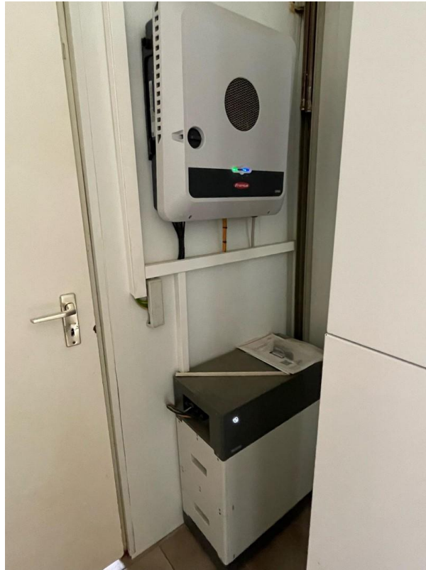
Photovoltaik mit Speicher
