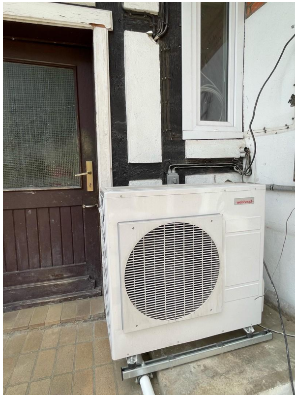
Außenmodul der Wärmepumpe
