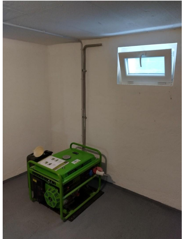
5 KW Strom-Aggregat im Keller
