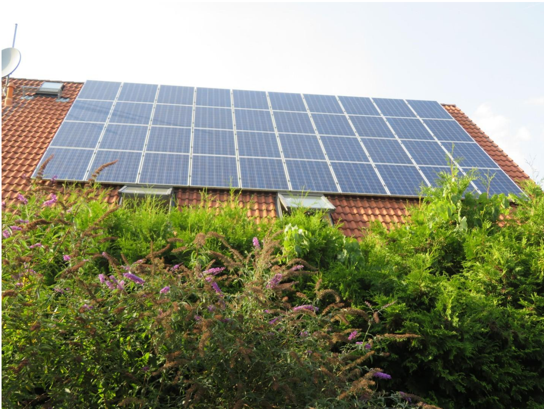
Dach mit Photovoltaikanlage
