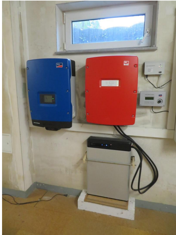
Wechselrichter und Batterie
