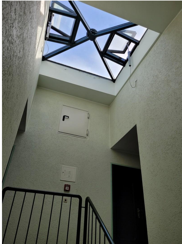
Treppenhaus mit Rauchabzug
