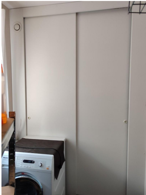
HWR Be- und Entlüftung
