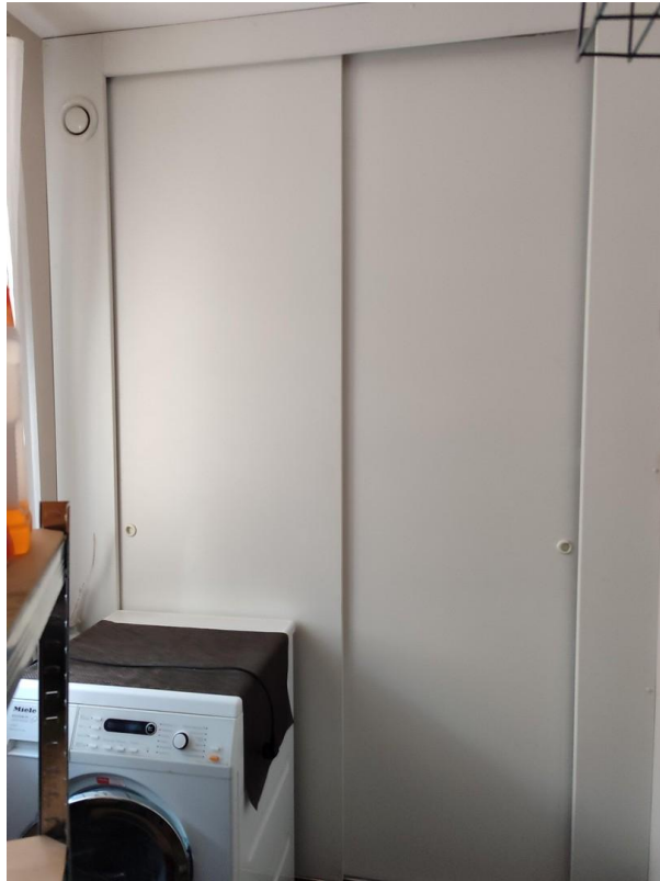
HWR Be-und Entlüftung
