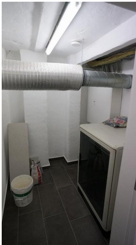
Untergeschoss EDV Raum
