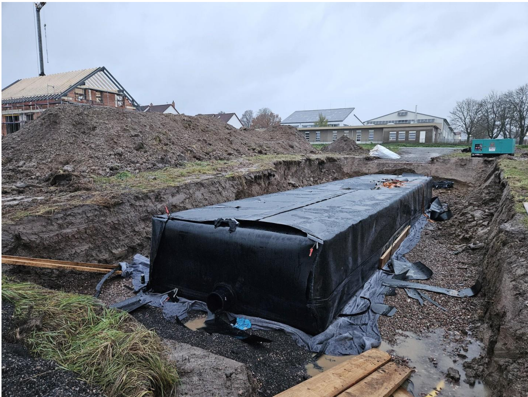
Regenrückhaltung Graben Nord
