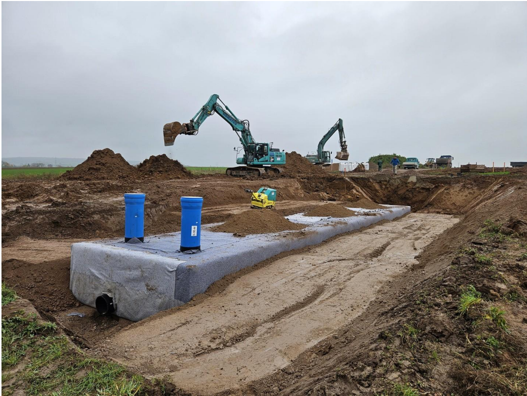
Regenrückhaltung Graben Süd
