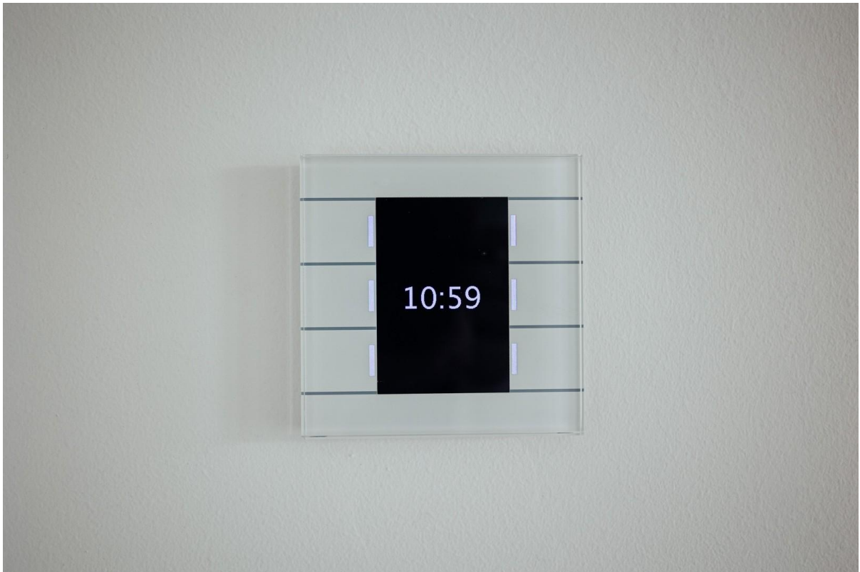
Lichtschalter und Steuerung
