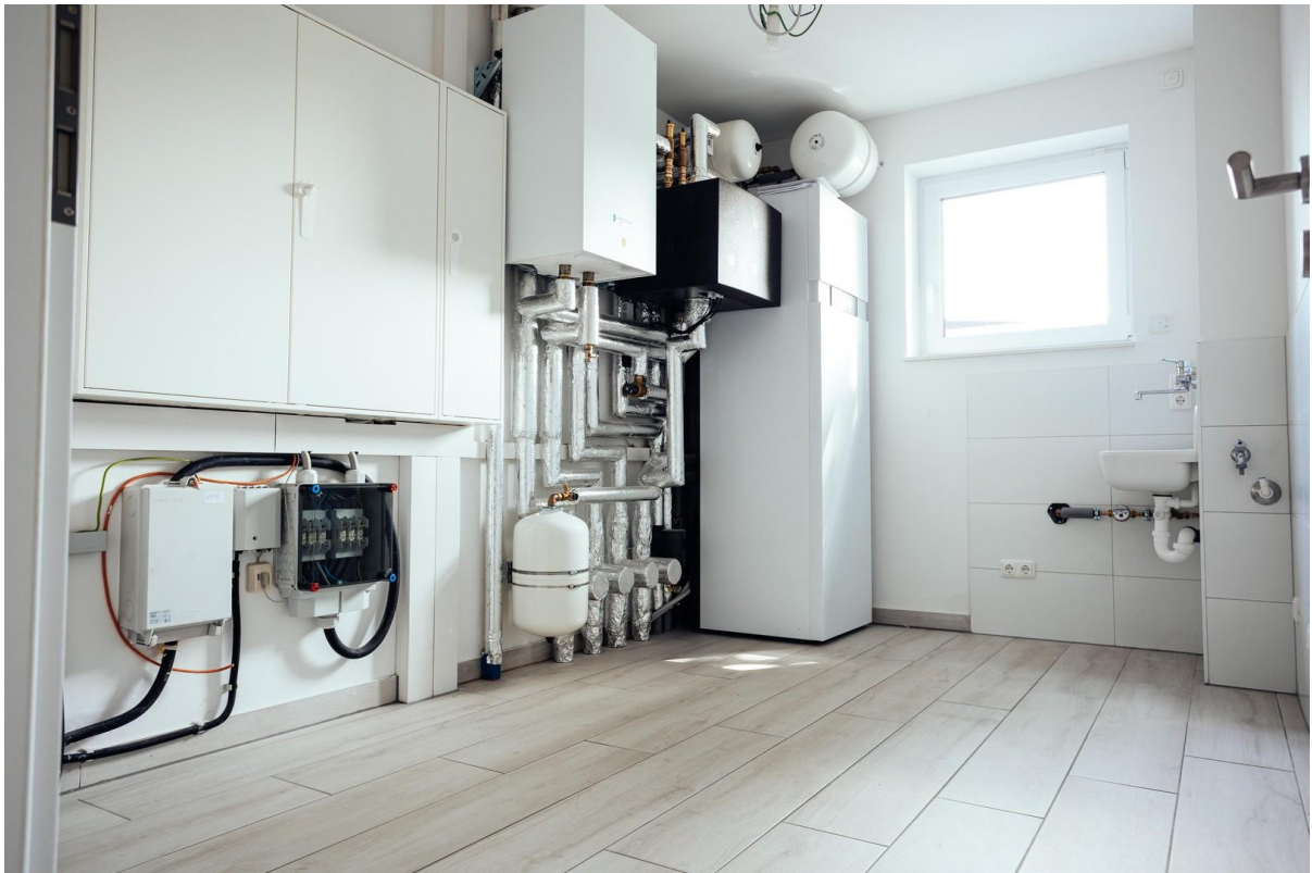
Erdwärme Heizung und Kühlung
