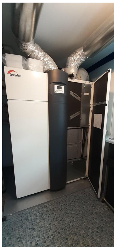
Wärmepumpe mit Be-Entlüftung
