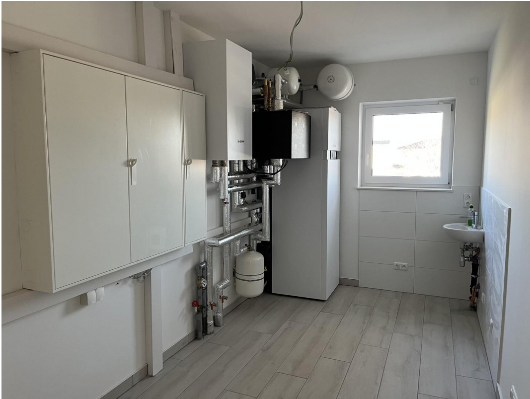
HWR, IT, Heizung und Kühlung
