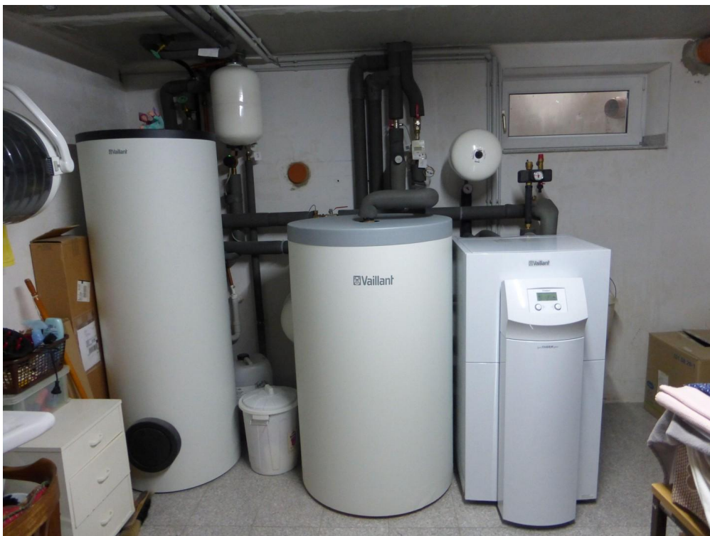
Wärmepumpe mit Wärmespeicher
