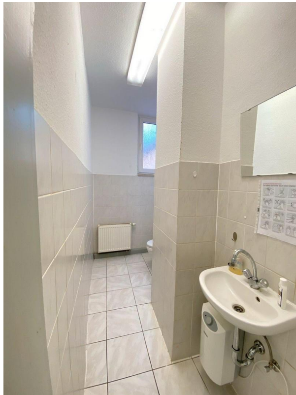
Büro WC hinten
