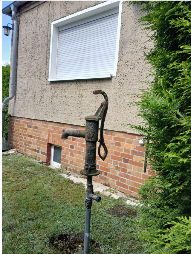
Brunnen manuell u. elektrisch
