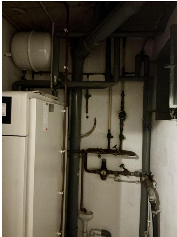
und isolierte Heizungsrohre.
