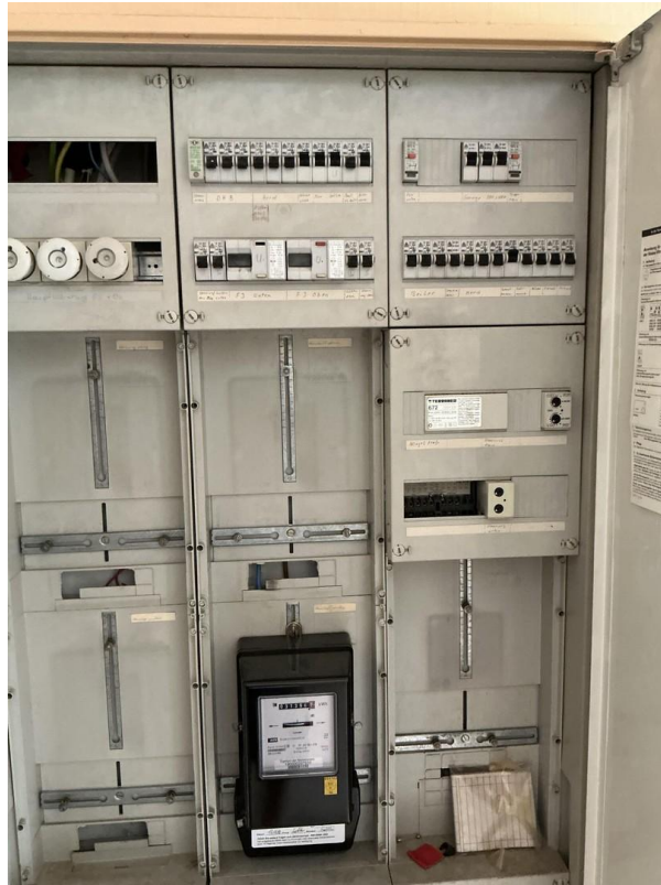
Strom gibts auch ;-)
