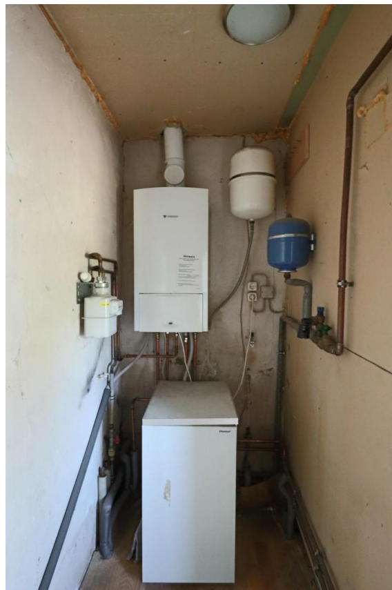
Heizung Haus B
