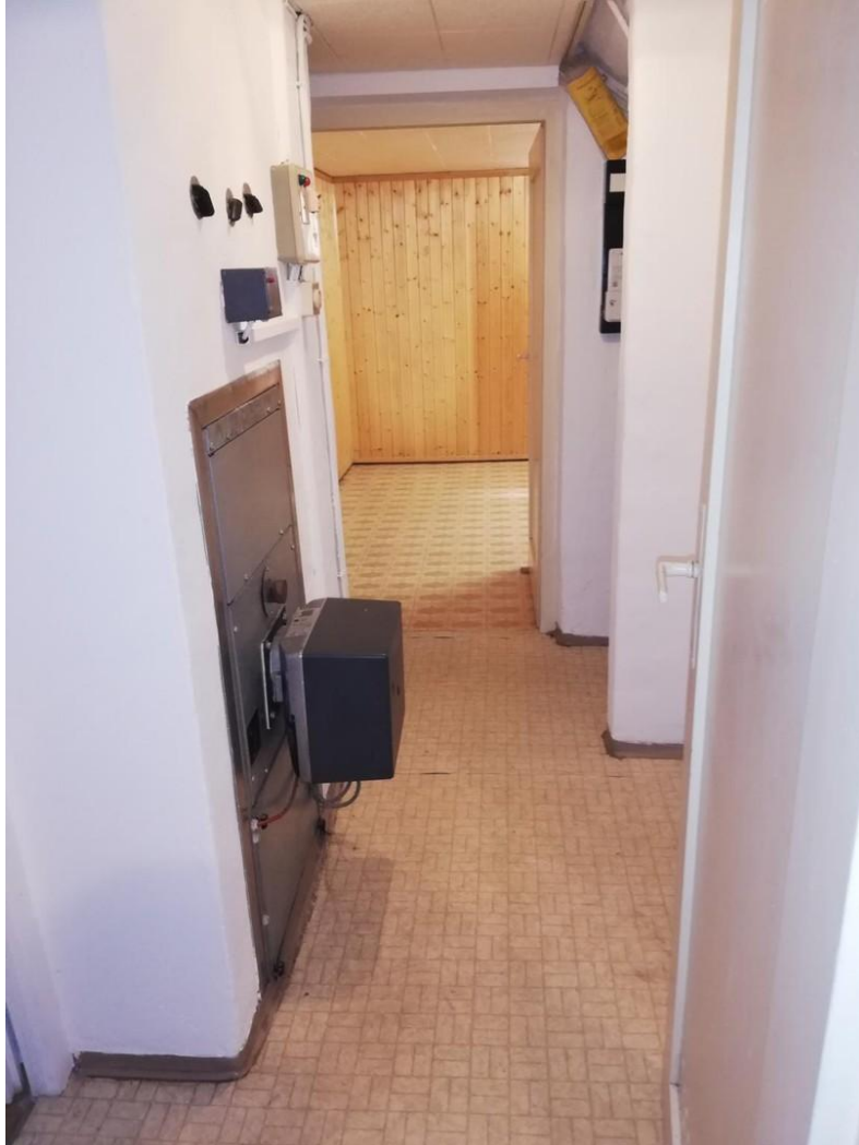
Kellerflur mit Heizung
