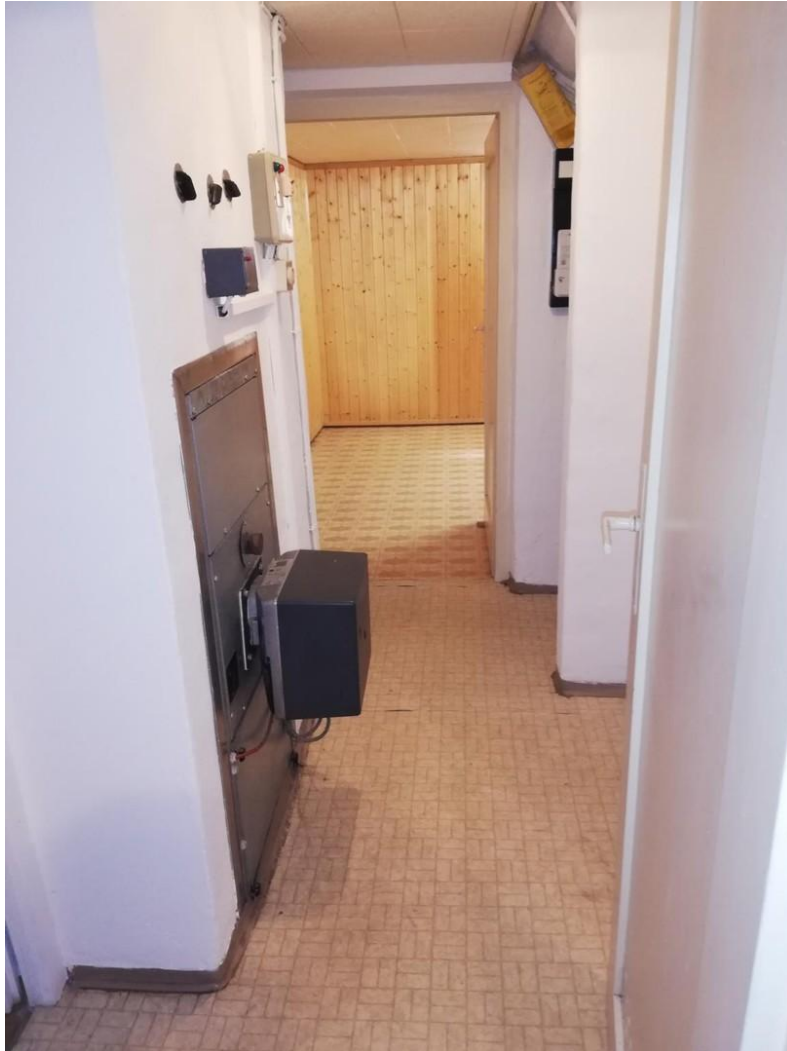
Kellerflur mit Heizung
