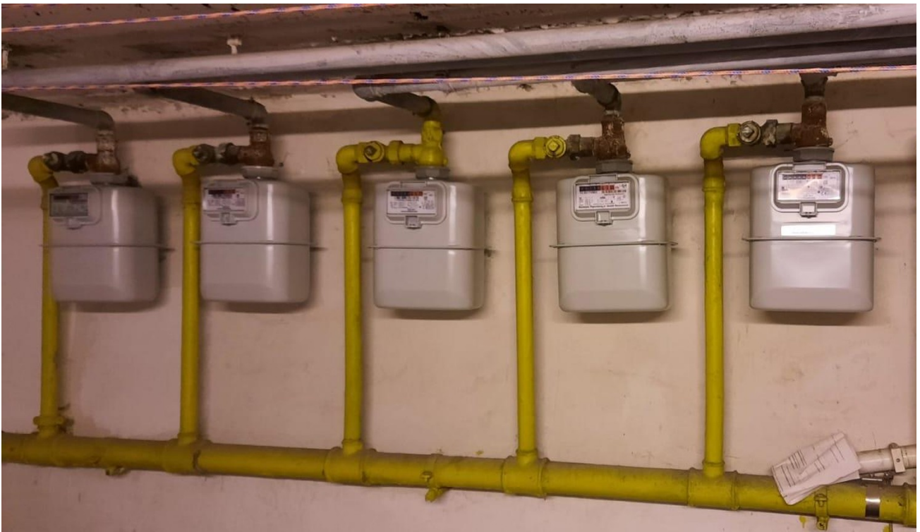
Gasverteilung Keller Haus 1
