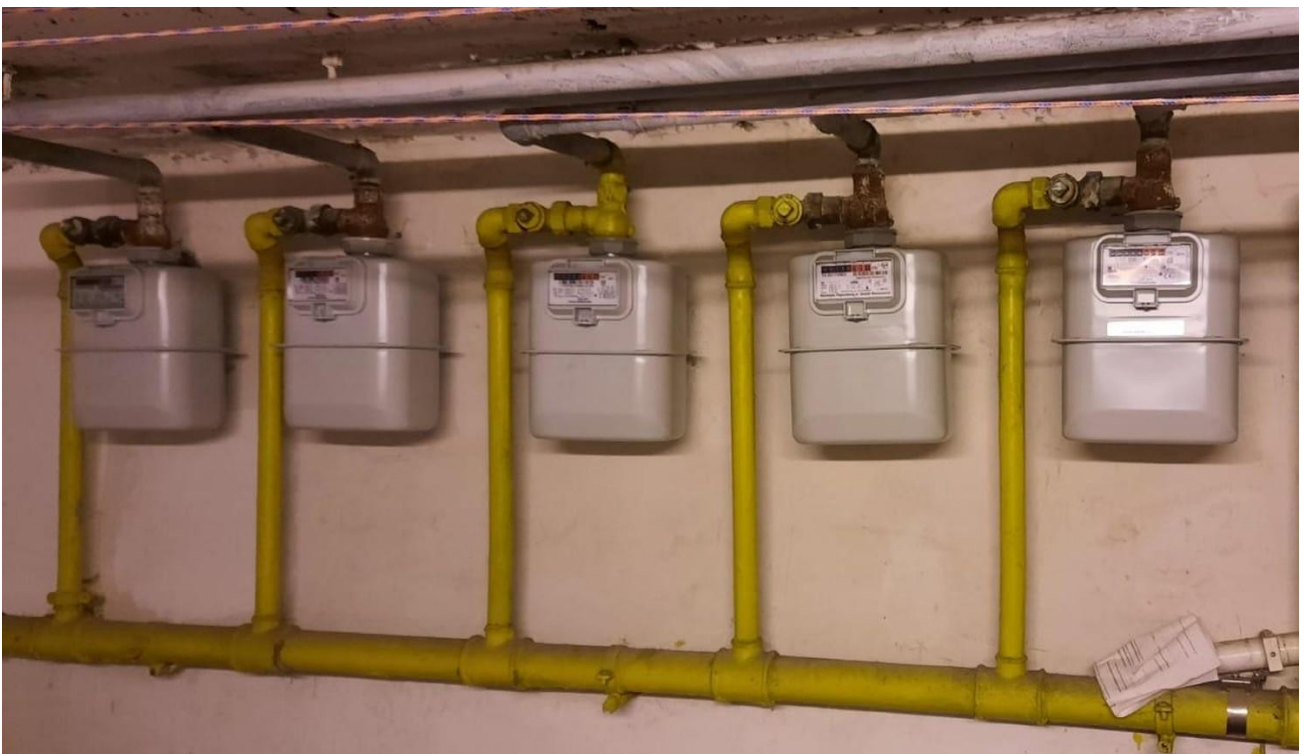
Gasverteilung Keller Haus 1
