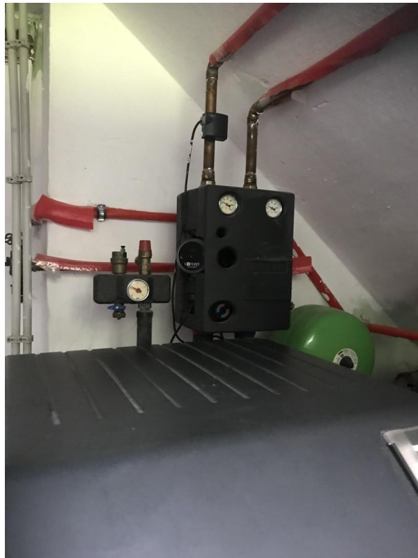
Ölheizung, neuer Brenner 2020
