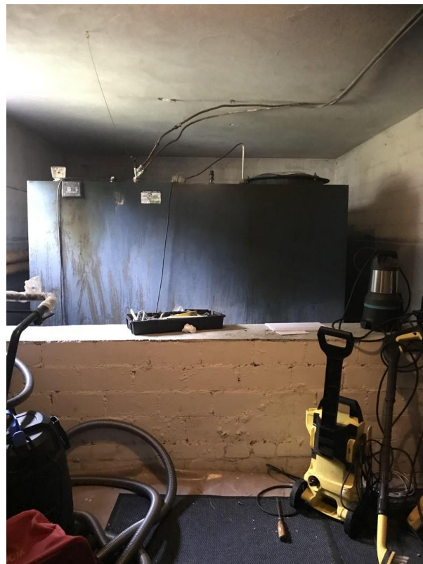
Öltank extra Raum im Keller
