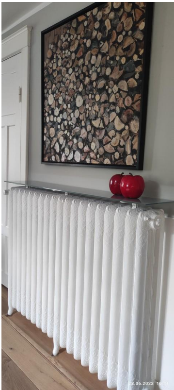
Alte gusseiserner Heizkörper
