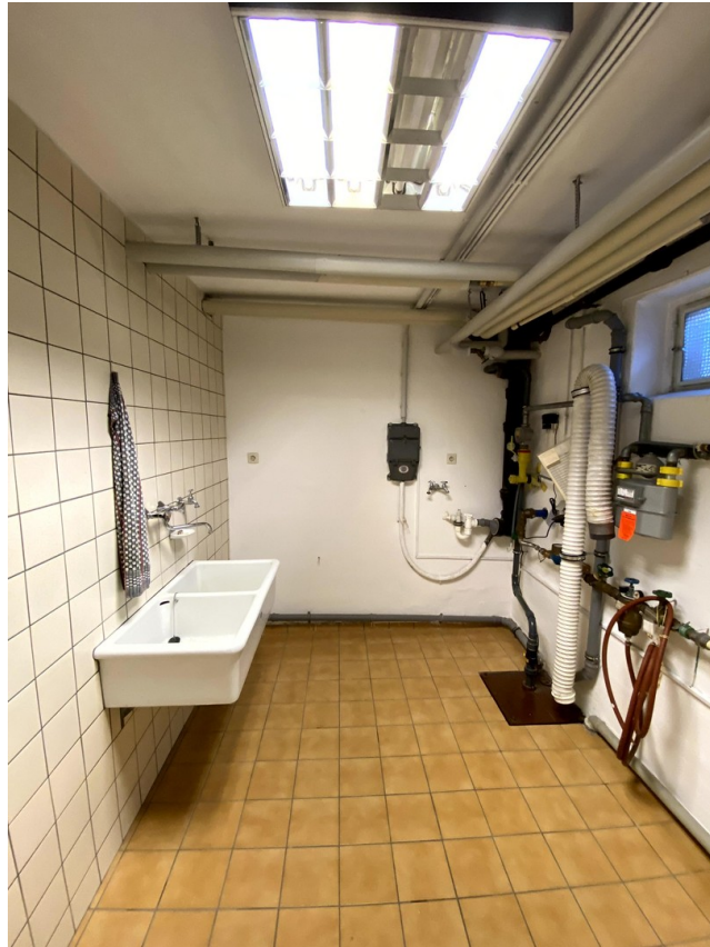
Hausanschluss Raum Waschen_Kel
