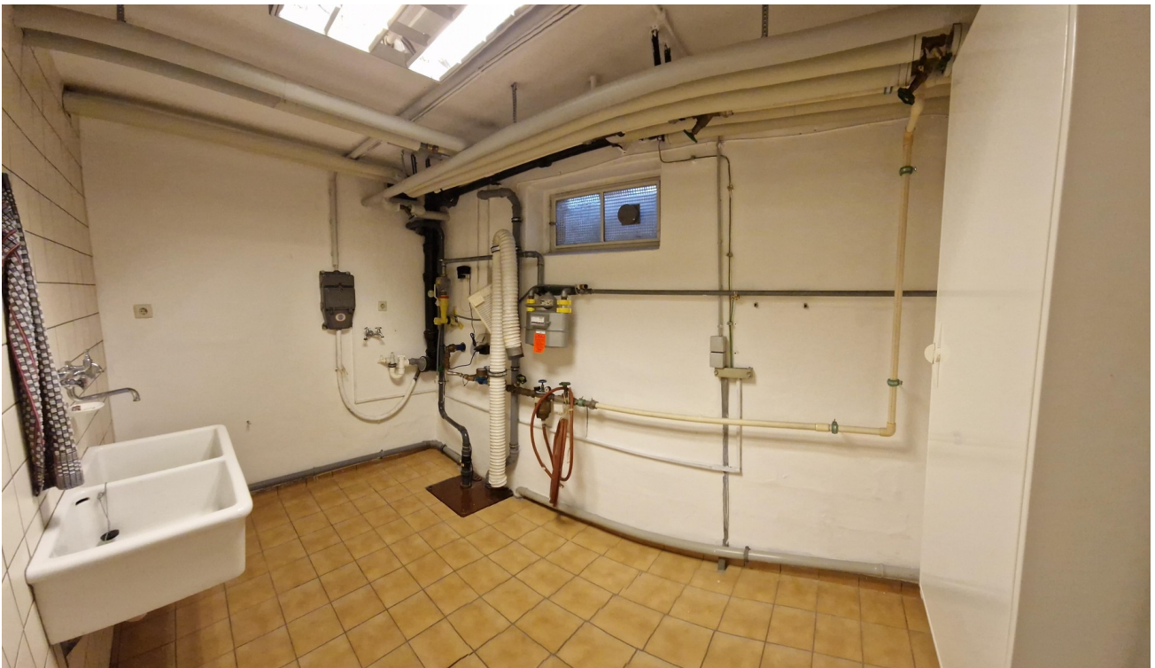
Hausanschluss Raum Waschen_Kel
