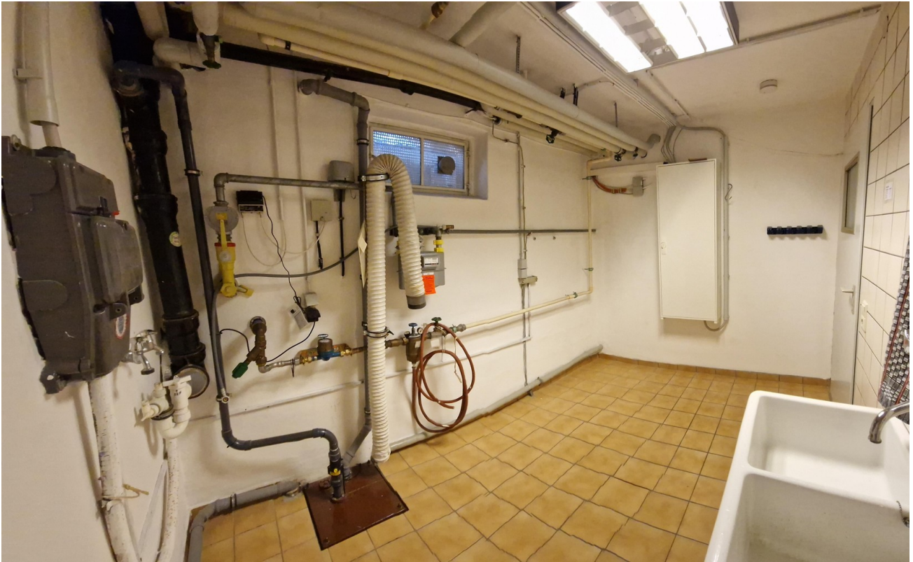
Hausanschluss Raum Waschen_Kel
