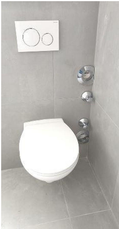
WC Anlage und Wasserzähler
