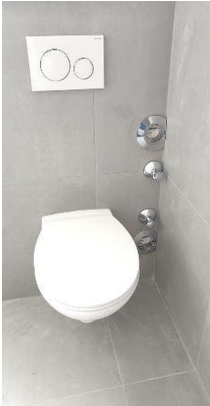
WC Anlage und Wasserzähler
