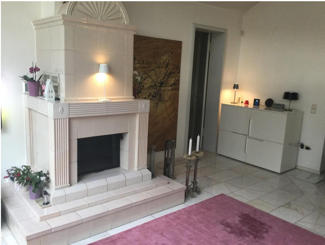
Kamin mit Heizkessel Pelletts
