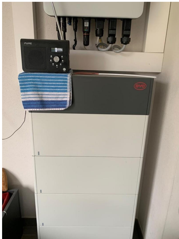
BYD 10 KW Speicher
