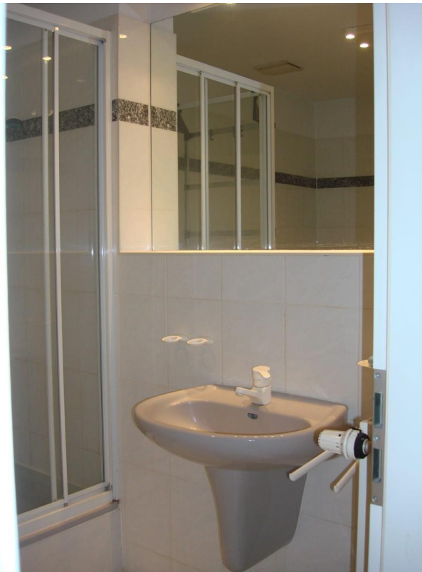
Waschbecken mit Halbsäule
